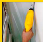
2 Instalação de esquadrias e furos em quadros de madeira. Furadeira sem impacto STDR5510.
