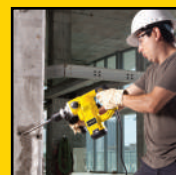
4 Perfuração no concreto, instalação de vergalhões e pisos de madeira. Martetele SDS Plus STHR1232K / SHR263K / STHR202K.
