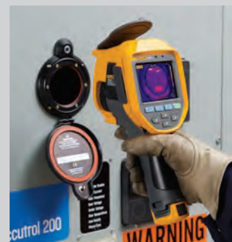
A Janela IR da Fluke permite inspecionar equipamento elétrico sem abrir as portas do painel.
