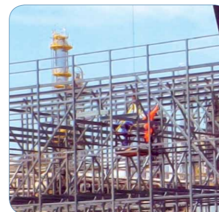
Torre de resfriamento construída com perfis estruturais pultrudados em fibra de vidro
